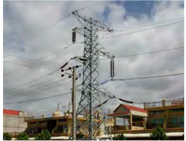
115/230kV 訓練用鉄塔及び送電線（供与機材）
