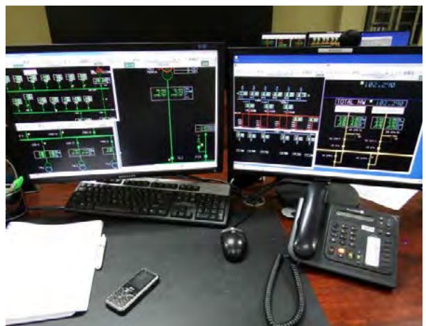
NCC SCADA システム画面
