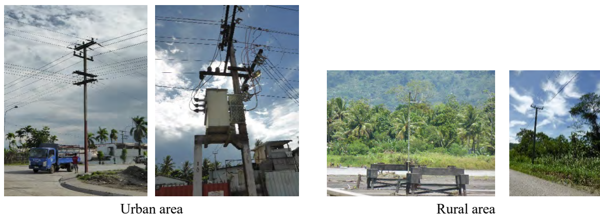
図 2-6 レイ地域の配電設備の写真
