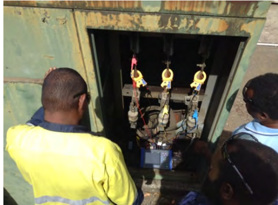
図 8-2 測定実習の状況(変圧器)
