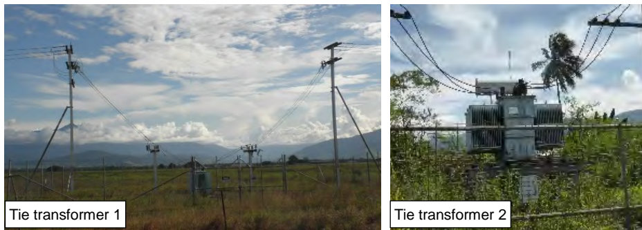
図 2-20 昇圧用変圧器の写真
