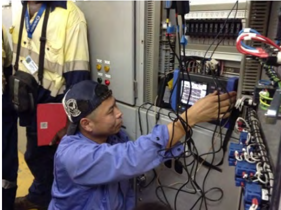
図 8-1 測定実習の状況(Taraka 変電所)
