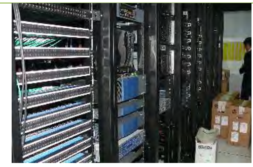
写真-16: セントラルでデータを一元管理するためのサーバールーム。24 時間空調管理する予定。
