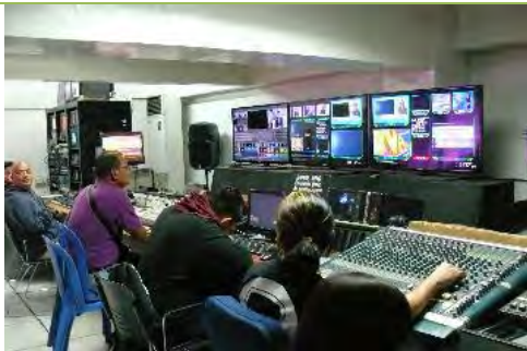
写真-11: 生放送中のスタジオコントロールルーム。
