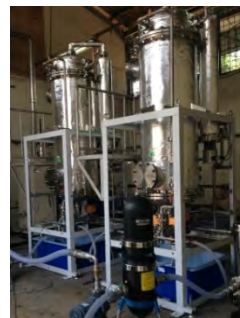
処理水送水用ポンプ及びフィルターの試運転時の様子
