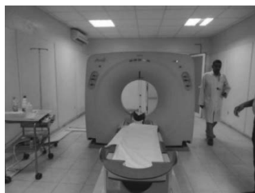
・シェイクザイド病院-1 画像診断エリアのCT室。東芝製の4列マルチCT（コンピュータ断層撮影装置）が配備されている。
