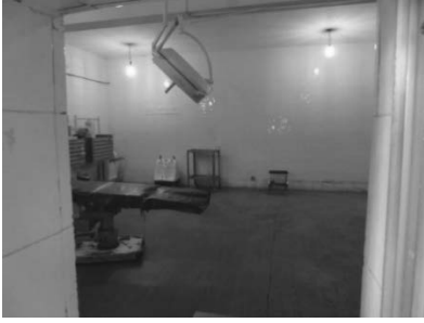
・セブカ保健センター-1 センター内の手術室。手術台、无影灯（ハロゲンランプタイプ）、吸引機が配備されている。
