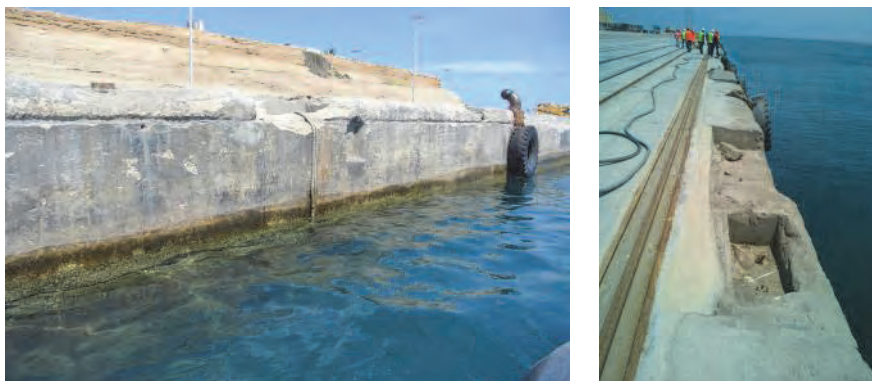
Figura 2.3 Condições da Estrutura Superior do Muro da Zona 3B
