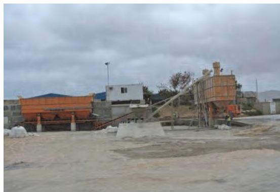
Fábrica de Betão
