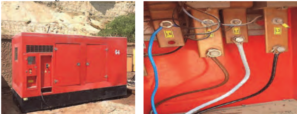
Figura 2.9 Gerador da SOGESTER para Contentores Frigoríficos
