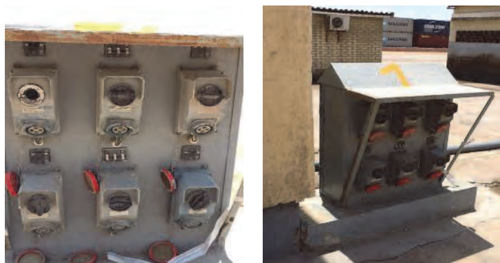
Figura 2.8 Quadros Actualmente Existentes de Tomadas de Contentores Frigoríficos
