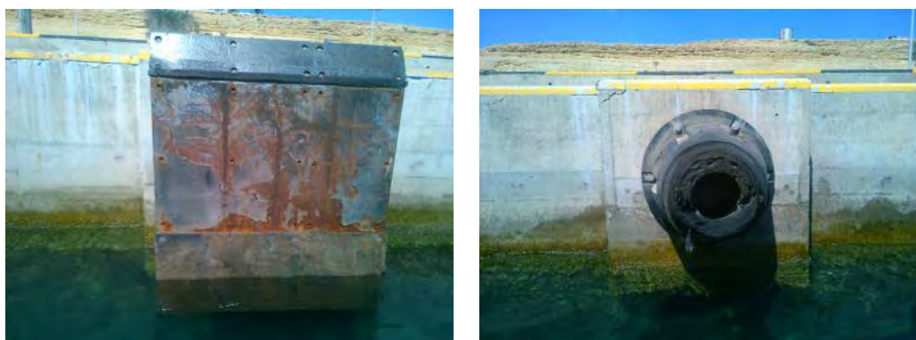
Figura 3.9 Danos na Defesa e na Placa de Absorção de Choques do Muro da Zona 3A
