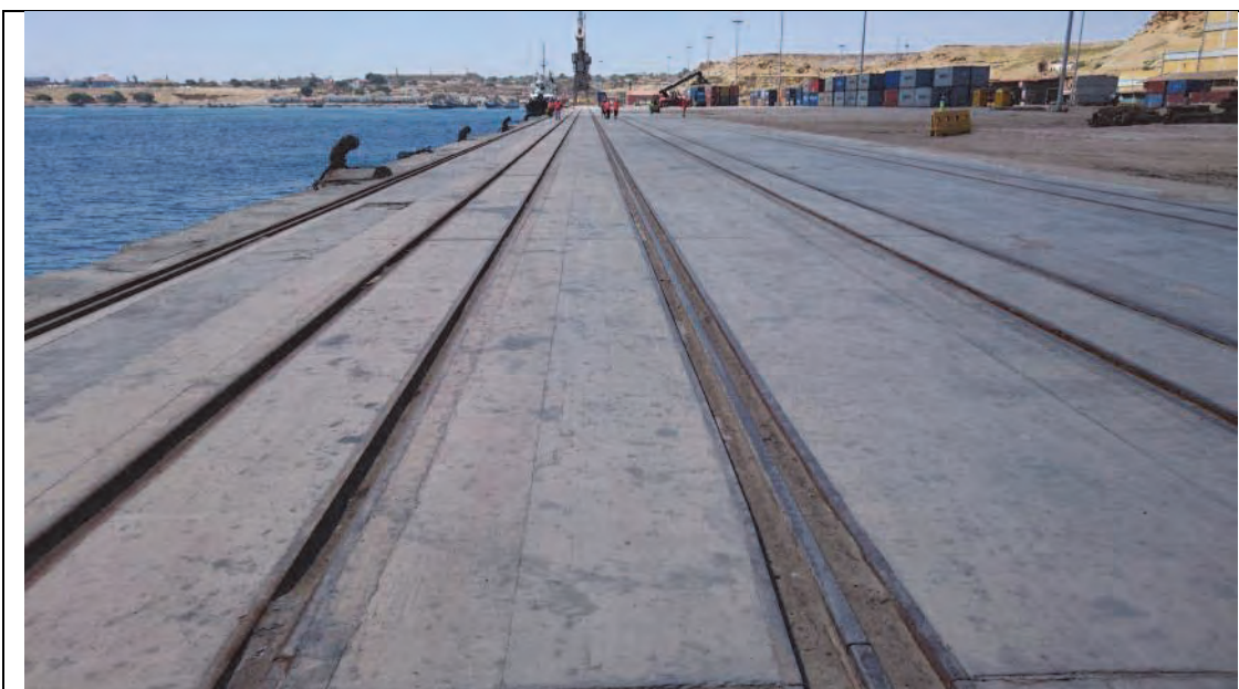
Situação Corrente-4 Condições do Pavimento do Cais da Zona 3B do Porto do Namibe (Foto tirada do lado da Zona 3A) Assentamento dos carris e pavimentação executados pela China
