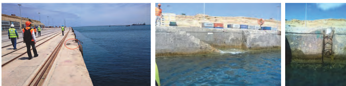
Figura 2.5 Muro da Zona 3B – Situação do Cabeço (Ausente) e Escadas
