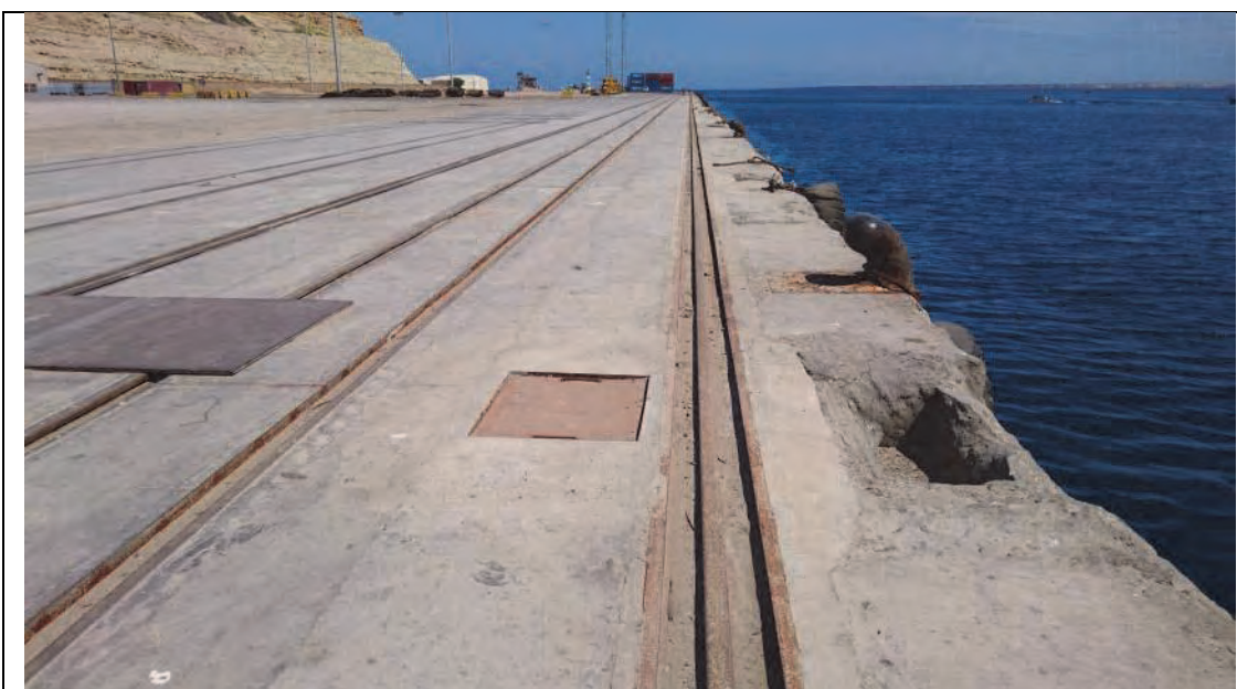
Situação Corrente-3 Condições da Estrutura Superior do Muro da Zona 3B do Porto do Namibe Danos no betão da estrutura superior do muro e na caixa de inspeção da água
