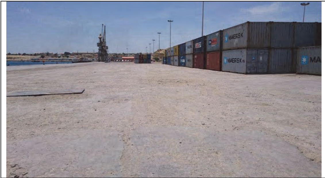
現況写真-5 ナミベ港 3B 岸壁ヤード現況 未舗装、凸凹あり、陥没箇所は鉄板にて補強
