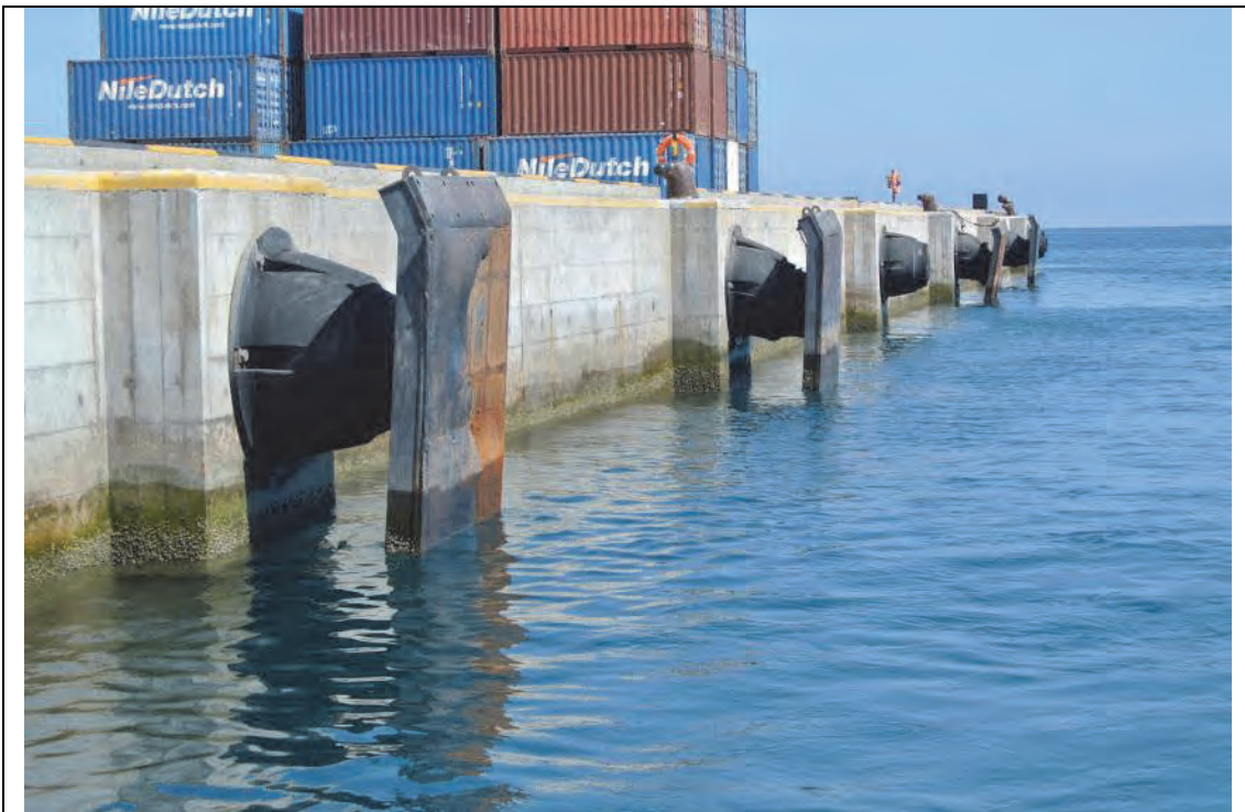
現況写真-8 ナミベ港 3A 岸壁（前回無償事業）現況 防舷材破損状況
