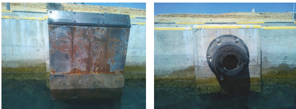
図 3.9 3A 岸壁 防舷材および前面受衝板損傷状況
