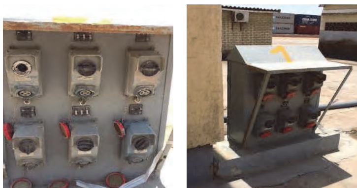
図 2.8 現状の冷凍コンテナプラグソケット板
