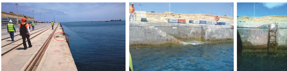
図 2.5 3B 岸壁 係船柱（脱落箇所）、階段、梯子の現況
