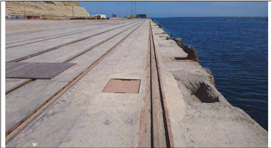
現況写真-3 ナミベ港 3B 岸壁上部工現況 岸壁上部コンクリートの破損、給水ピット破損
