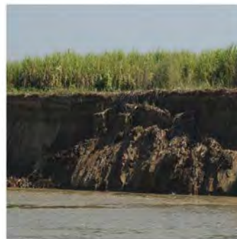
中州(雨季の濁流で堰が崩壊)
