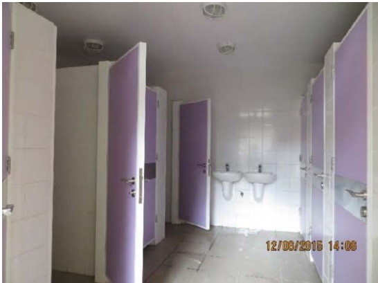
UNDP が改修したトイレ、前庭の屋根も同様
