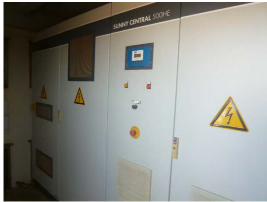
(d) Inverter panel
