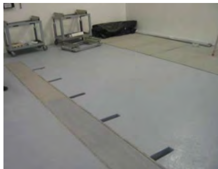
20kV 開閉設備の引出しスペース
