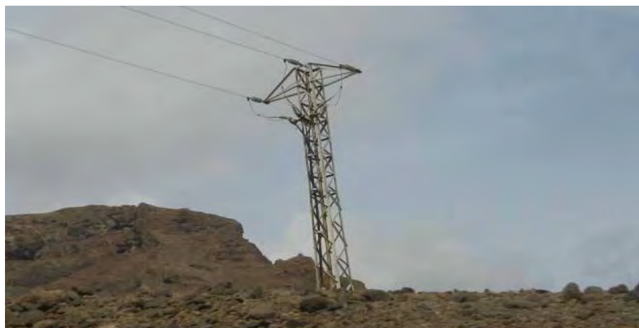
図 9.1-8 20kV 地中ケーブル引込鉄塔 (C. Norte から Juncalinho 間)
