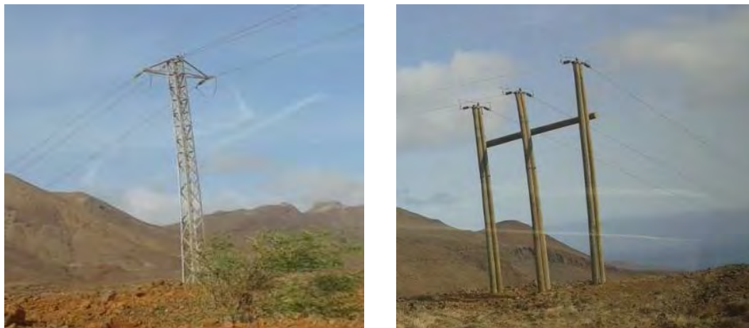
図 9.1-7 20kV 送電設備 (R. Brava から Cacimba PS 間)
