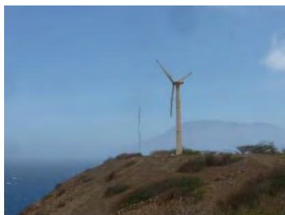
風車・風況観測設備全景
