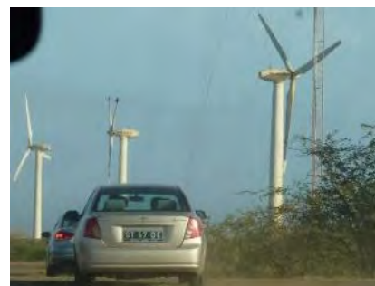
運転停止している Electra 設備 (Nordtank 製風車×3 基)
