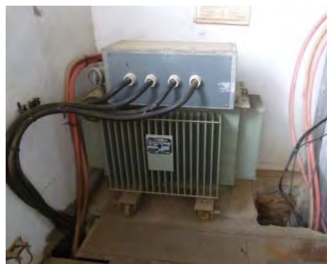
所内用変圧器：250kVA (GONELLA 製) (20kV/400V)
