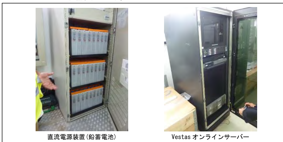
図 7.1-16 電気設備状況
