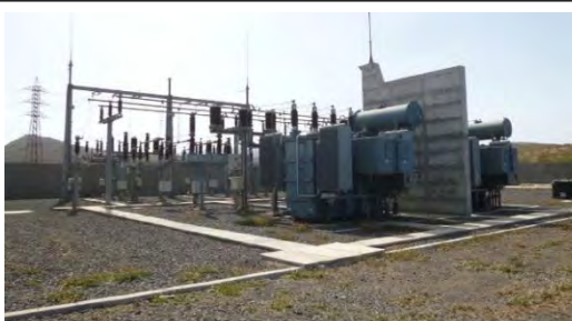
変電所構内 (2バンクの拡張スペース有り)
