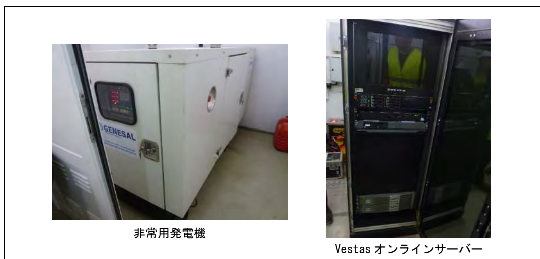
図 7.1-14 電気設備状況
