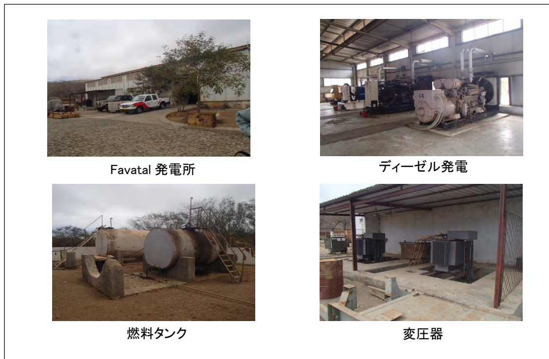
図 6.1-9 Brava 島ディーゼル発電設備状況
