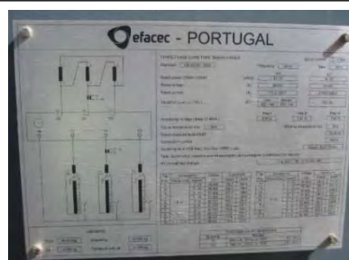
変圧器銘板 (ポルトガル製)
