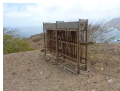
ダミー負荷(抵抗) [タワー下設置]
