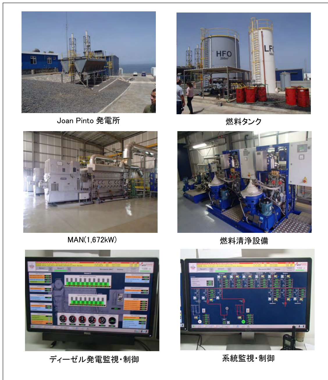
図 6.1-8 Fogo 島ディーゼル発電設備状況
