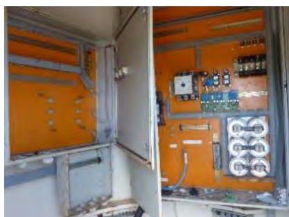
タワー内電気盤
