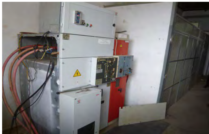
20kV 開閉装置（左：efacec 製、中央：ALSTOM 製）と変圧器（右奥）
