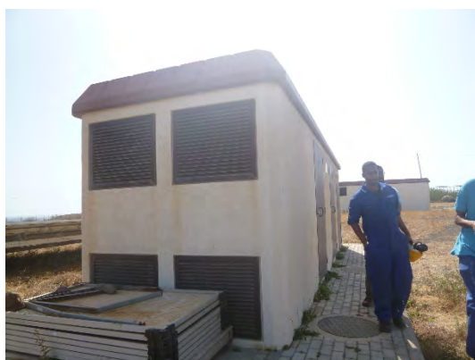
(c) インバーター、変圧器建屋 (PT)
