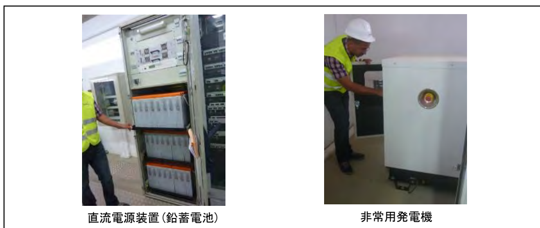
図 7.1-10 電気設備状況
