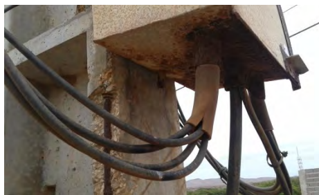
ケーブル BOX の拡大写真 (錆による腐食がひどい)
