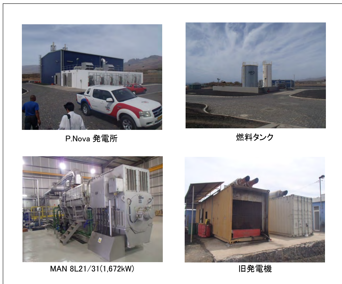
図 6.1-1 Santo Antão 島ディーゼル発電設備状況
