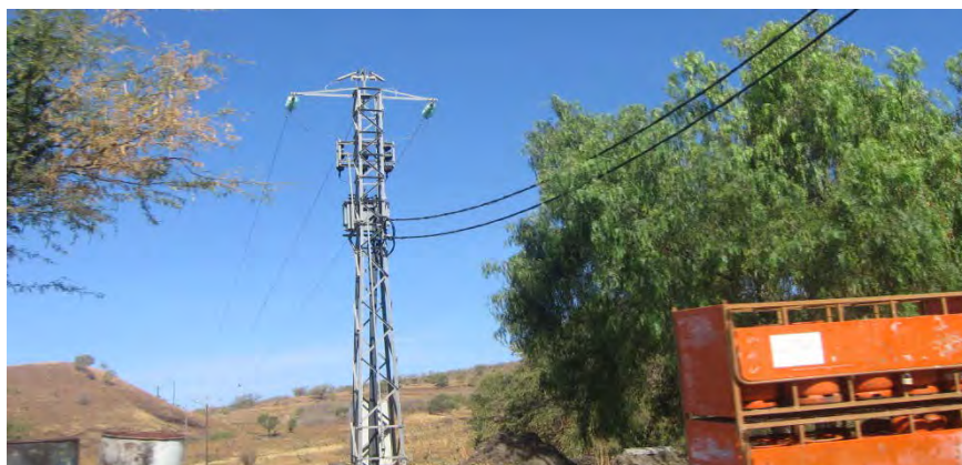
図 9.1-23 柱上変圧器設置の鉄塔
