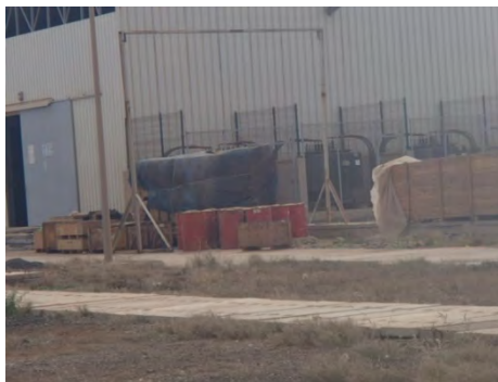
São Vicente から移設された CAT(3,840kW)[不使用]
