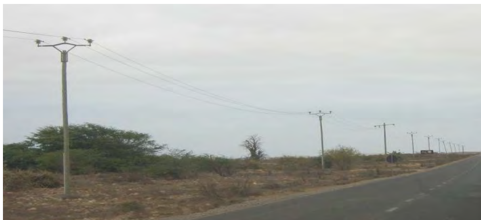
図 9.1-15 北西部の 20kV 架空送電線
