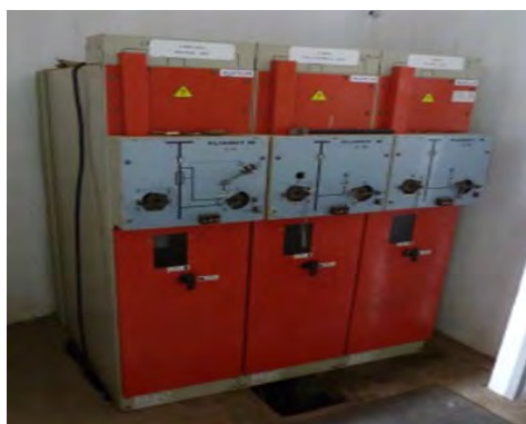
6kV 開閉装置 (ALSTOM 製) (フィーダー2 回線)
