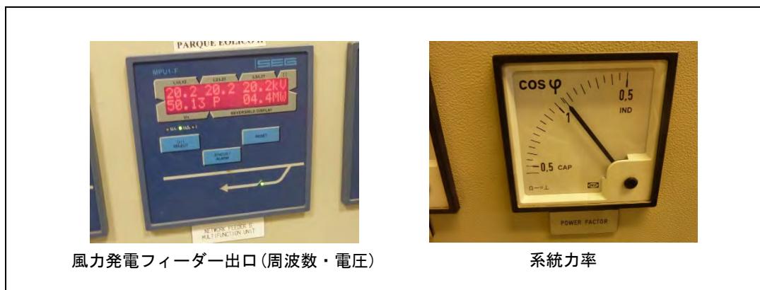
図 7.4-4 Lazareto 発電所監視計器（周波数・電圧・力率）
