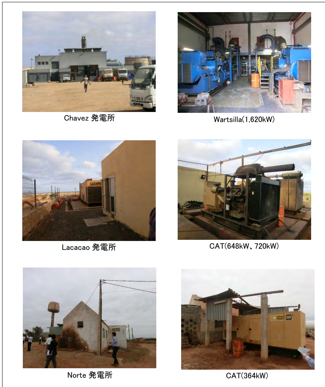
図 6.1-5 Boa Vista 島ディーゼル発電設備状況
