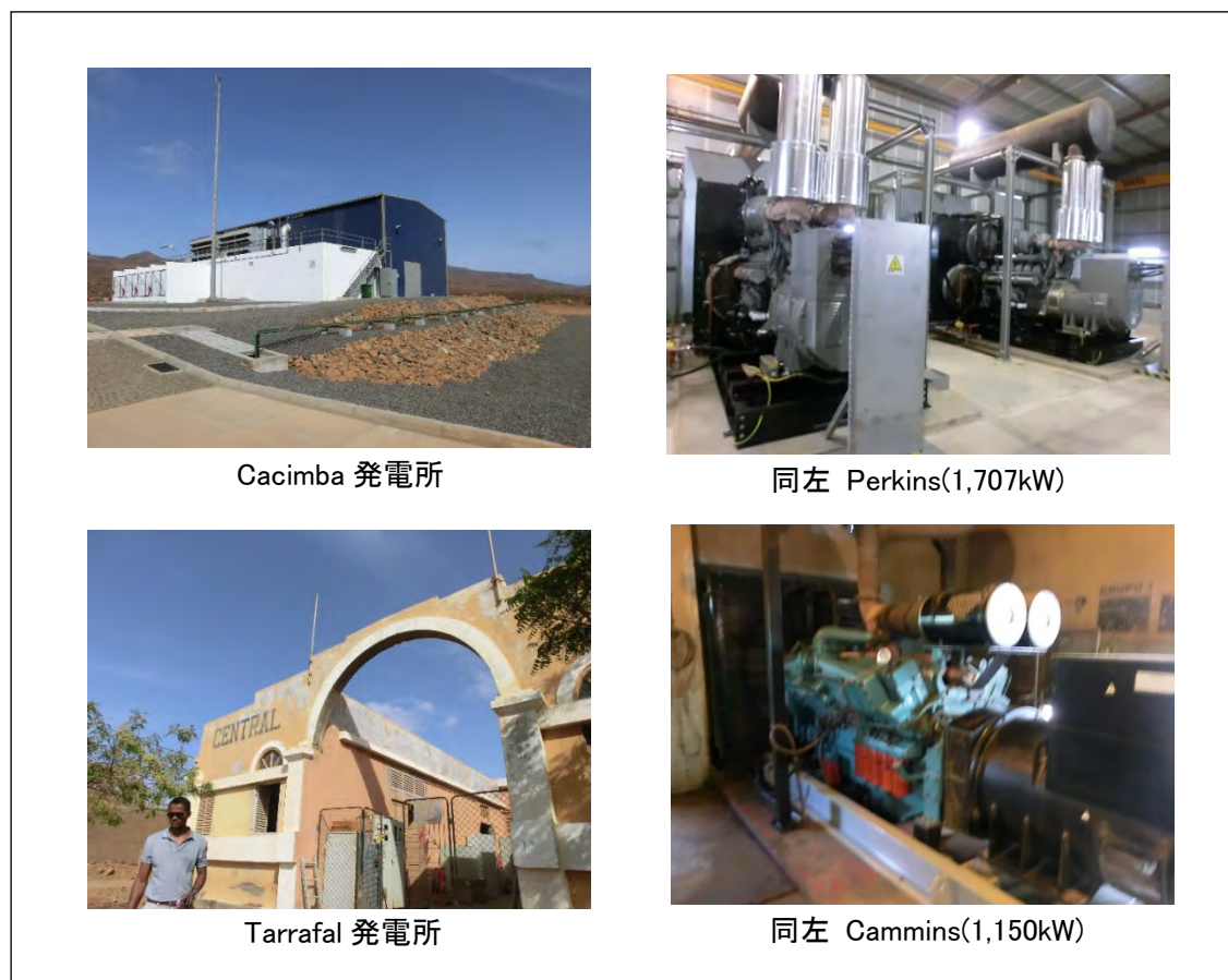
図 6.1-3 São Nicolau 島ディーゼル発電設備状況
