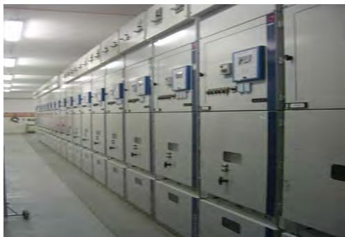
20kV 開閉設備
