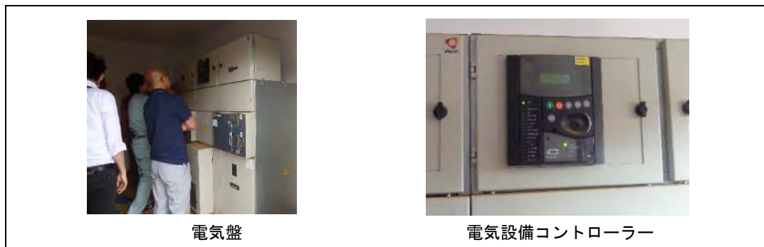
図 7.1-34 電気設備状況
