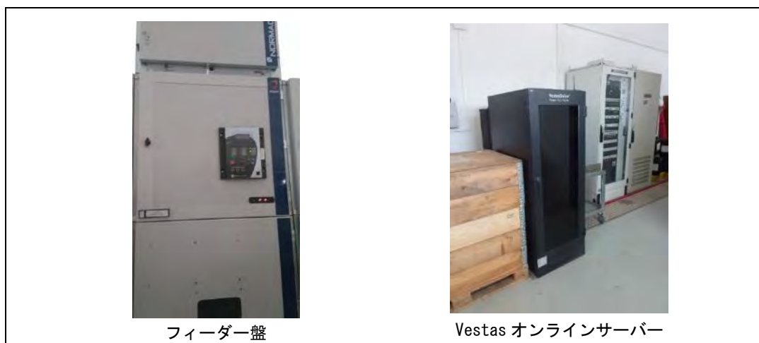
図 7.1-12 電気設備状況
