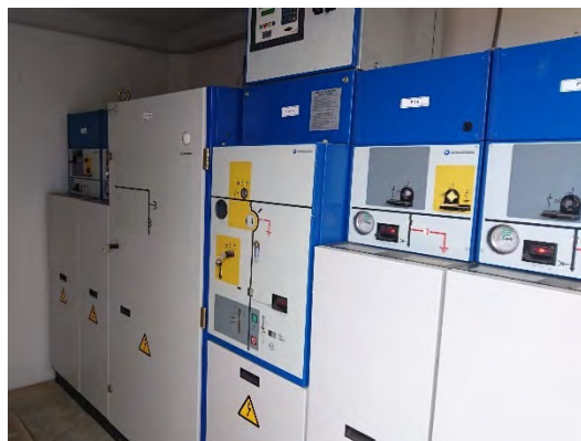
(b) 電源接続盤 (PS)
