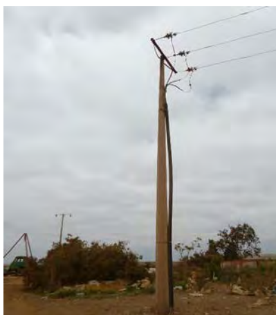
図 9.1-13 F. d. figueiras の 10kV 送電線引込み柱
