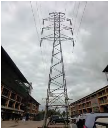
132 kV 送電線の状況 カンパラ北—ルゴゴ回線
