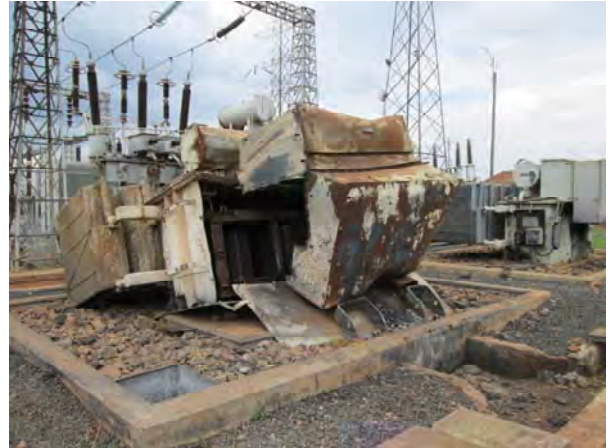
カンパラ北変電所 燃烧したリアクトル
