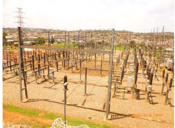
ムトゥンドウエ変電所 全景
