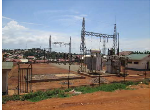
カワラ変電所全景
