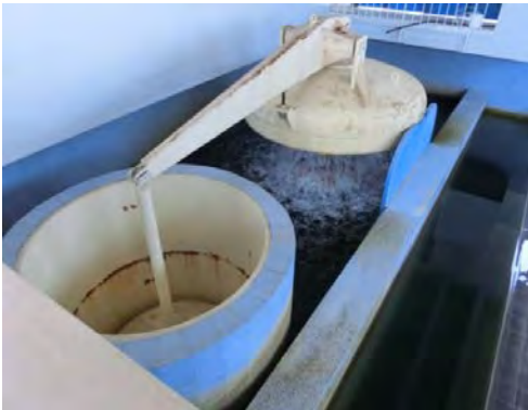
NO. 59 配水タンクの自動水位弁 (スース支社)
