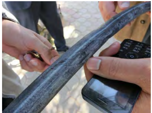
No. 22 亀裂の入ったポリエチレン給水管
