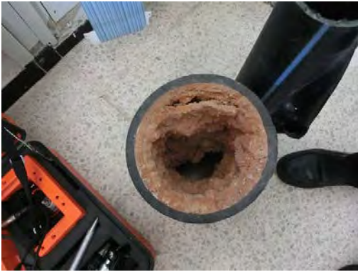
No. 17 カルシウム質のスケールの詰まった配水管 (ポリエチレン管)
