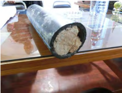
No. 19 配水管の詰まり (ポリエチレン管) タタウィン営業所
