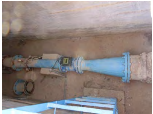
No. 24 配水タンク送水側の電磁流量計 タタウィン営業所
