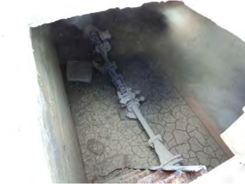
No. 27 減圧弁ボックスの内部
