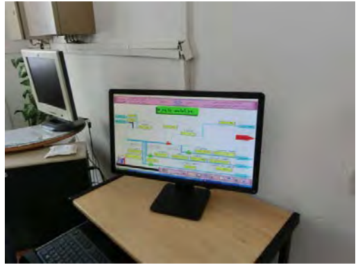
No. 34 エル・ケフ営業所のテレメーター・システム
