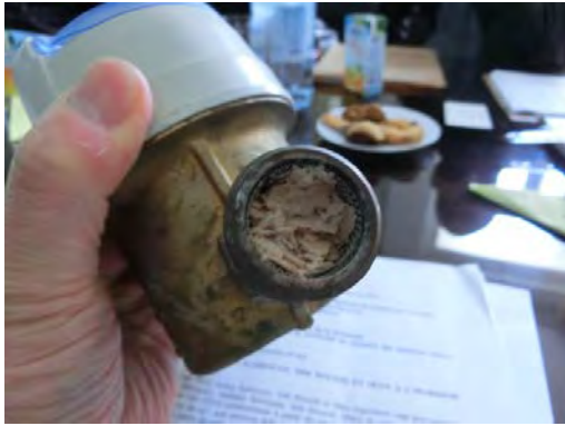
No. 9 水道メーターのカルシウム質のスケールによる詰まり
