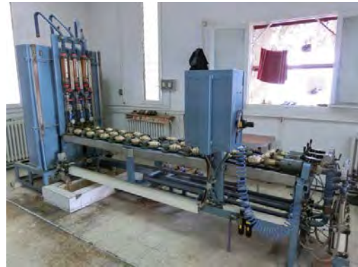
No. 12 工場内にあるメーター検定装置 15mmメーター10台×3列
