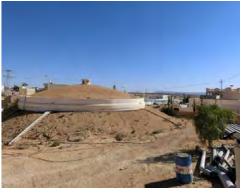
No. 57 5,000m 3 配水タンク (メドニン生産局)
