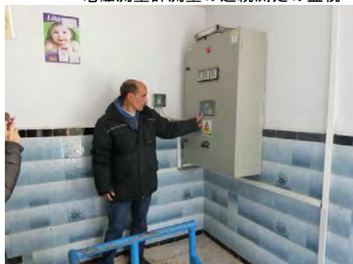
No. 32 テレメーター・システムの現場盤
