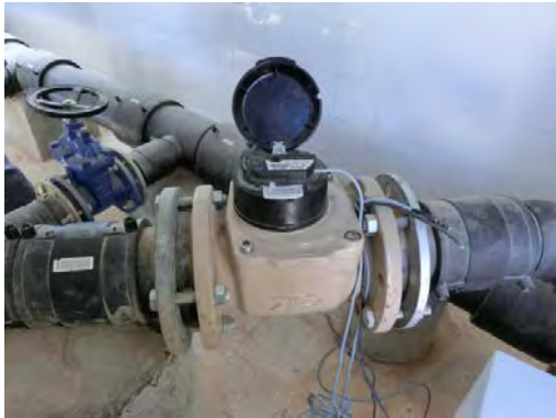
No. 25 配水タンク流出側の流速式流量計
