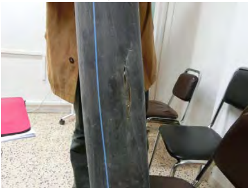
No. 21 縦に亀裂の入ったポリエチレン配水管
