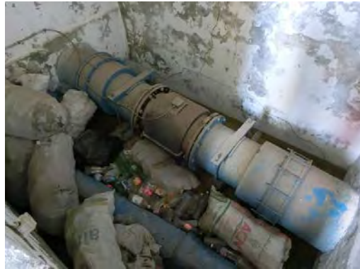
No. 26 配水タンク流出側の電磁流量計
