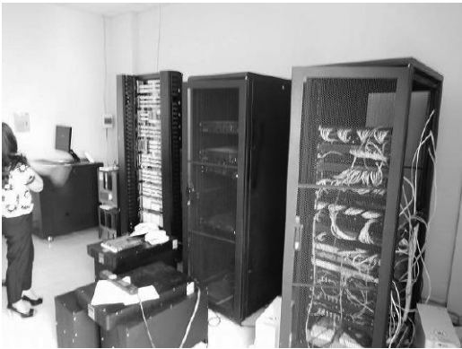
【写真14:サーバー室】
