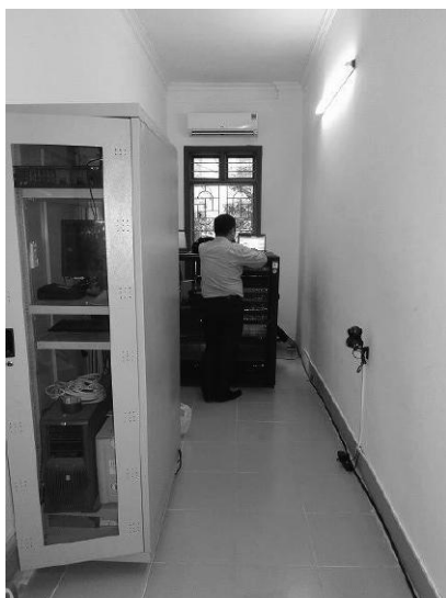
【サーバー室内 全景】
