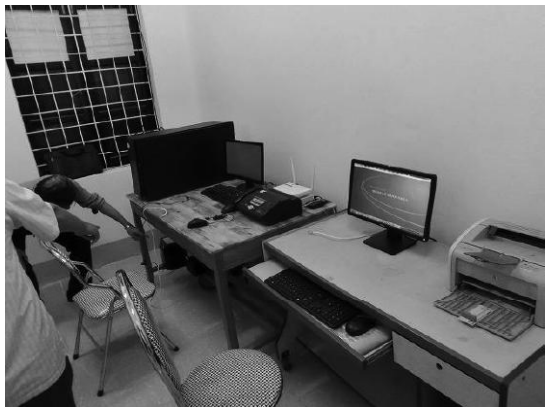
[写真 3: 病院内サーバー室]
