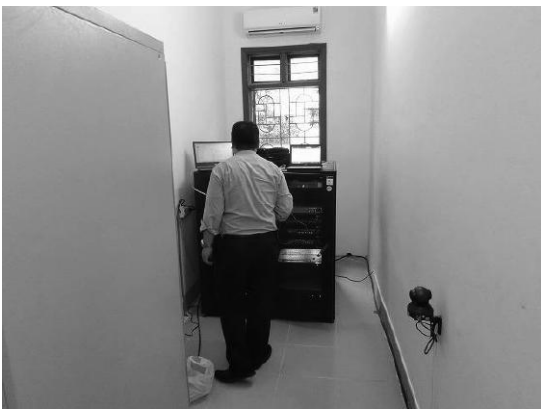
【サーバー室内】
