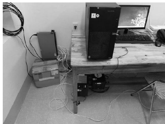
[写真 4: 病院サーバー機]
