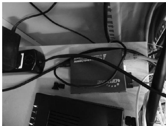
【メディアコンバータ電源をUPSから取得】
