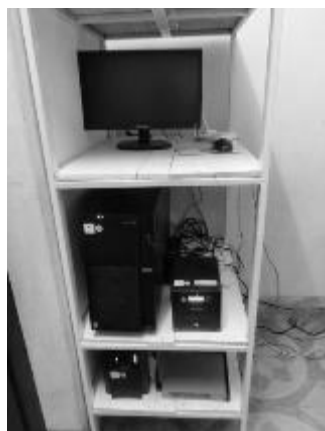
【写真 3:サーバー室内】
