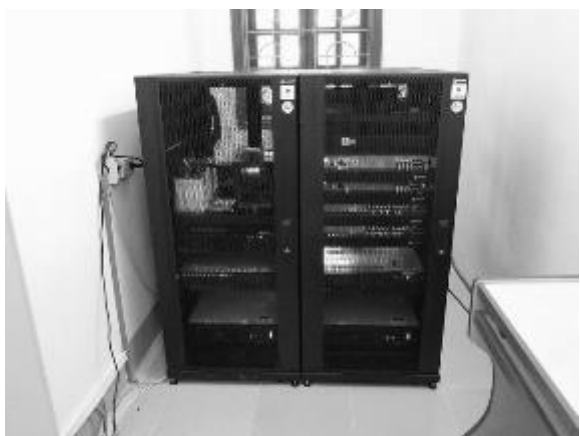
保健局内設置のデータセンターサーバー群 (2015年7月)
