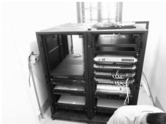
【写真 1:設置中のサーバー】
