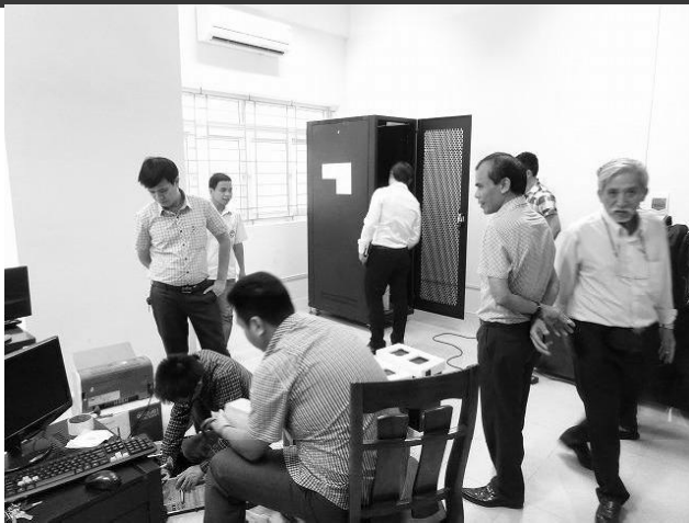
【写真 27:病院内サーバー室】
