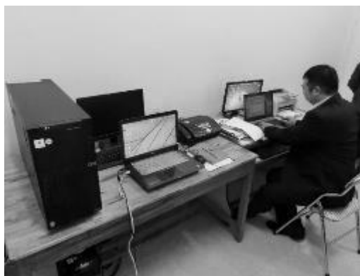
【写真 8:新設サーバー室】
