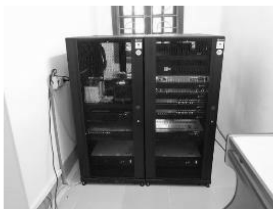
【写真 2:設置後のサーバー】
