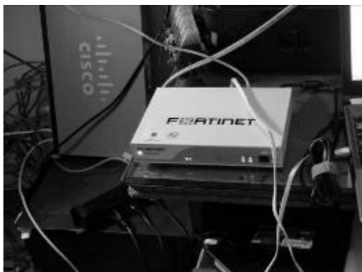
【写真 5:サーバー室内】
