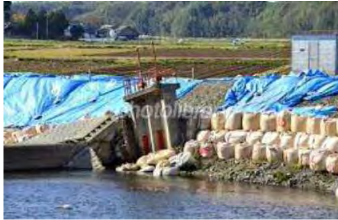
k) Collapsed culvert
