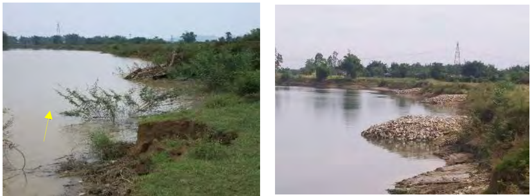
写真 3-4-2 ハティン省における工事前後の河岸侵食状況（水制 6 基）
