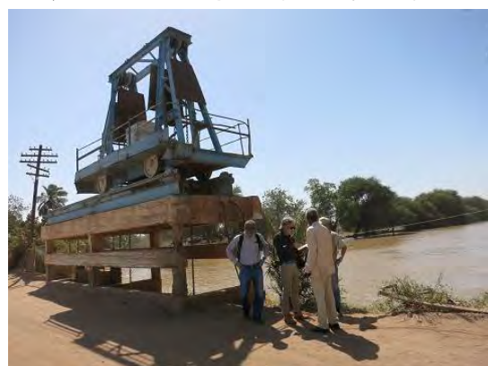
2/8 ゲジラスキームの老朽化したゲート
