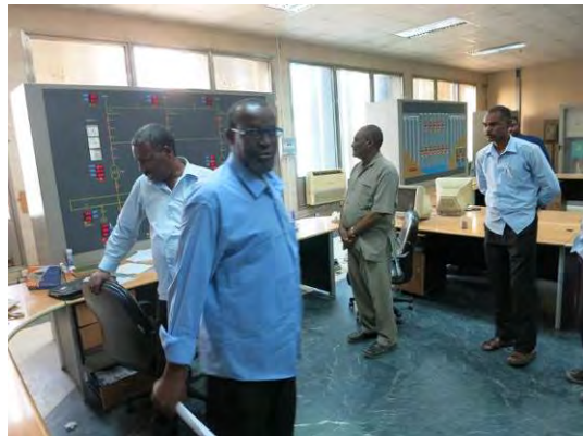
2/1 ギルバダムの中央監視室
