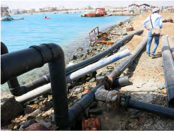
2/13 ポートスーダン海水淡水化施設 取水地点
