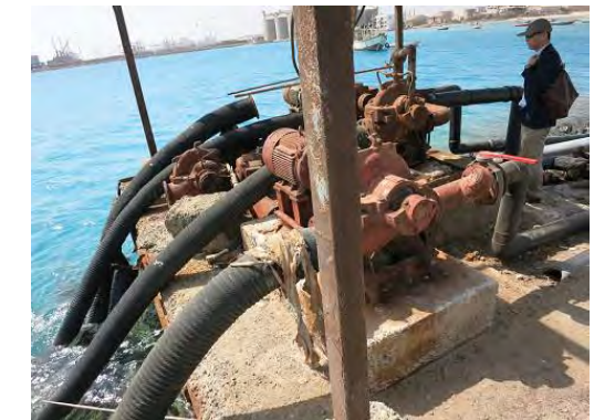
2/13 ポートスーダン海水淡水化施設 取水地点
