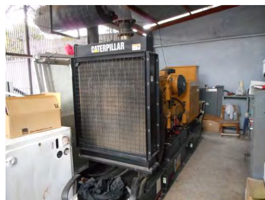
HIV/ウイルス棟用 自家発電設備 隣接するHIV/ウイルス棟及びワクチン倉庫に非常電力を供給している。
