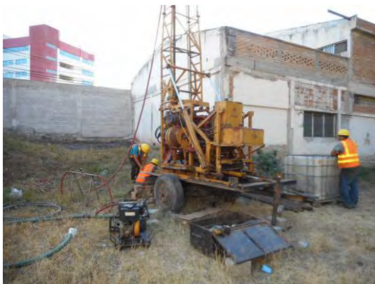
建設予定敷地 ボーリング調査 計4本のボーリングを行い良好な地盤を確認。
