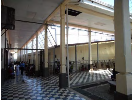
サンフェリペ病院 外来棟外観 屋根などに一部経年劣化がみられる。
