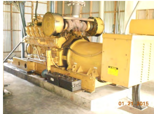
ディーゼル発電機 (CAT#2) の状況
