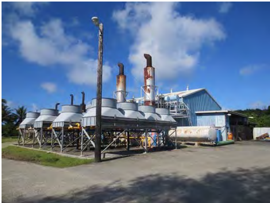
ダリプワイ (DALIPYAY) 発電所の状況 (撮影日：2015年1月18日)
