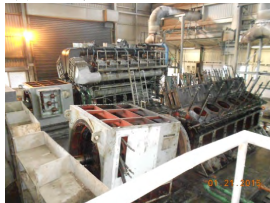
既設ディーゼル発電機の状況
