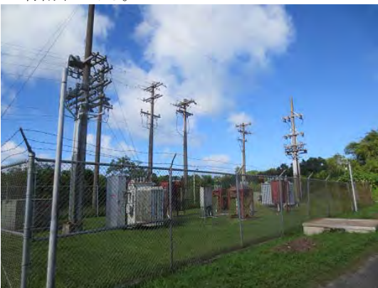
発電所内変電設備の状況 (撮影日：2015年1月18日)
