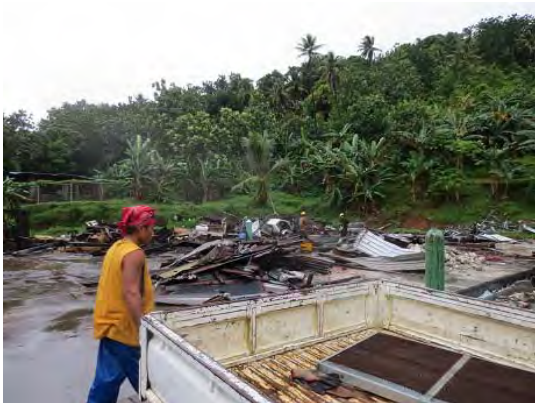
ネプコス発電所内の状況
