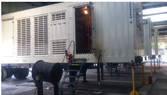
ディーゼル発電機 (P. Module#1~#3) の状況
