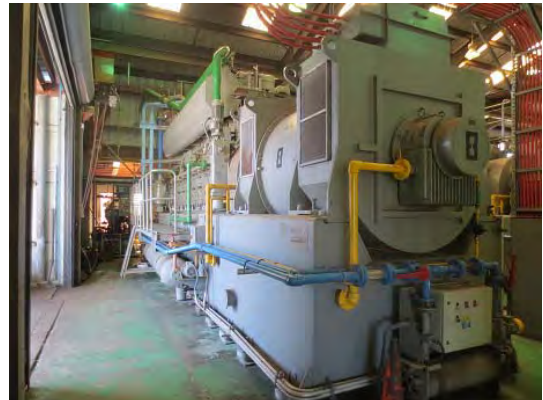
ディーゼル発電機 (8 号機) の状況 (撮影日：2015年1月18日)
