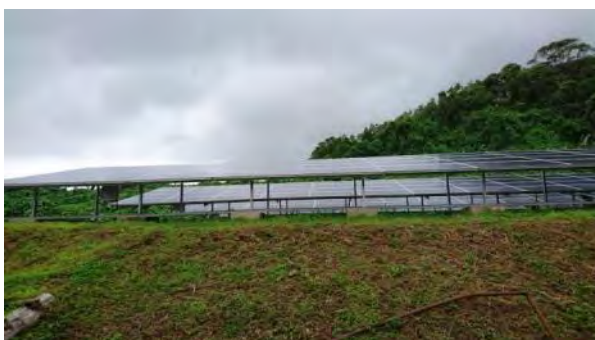
PEC 援助で据付けられた太陽光発電システム
