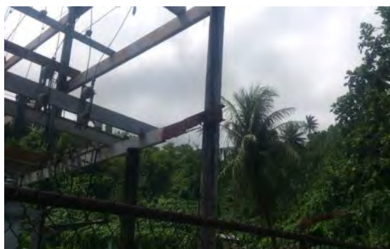
既設変電所の様子
