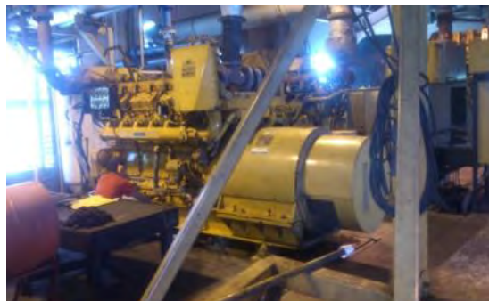
ディーゼル発電機 (4号機) の状況
