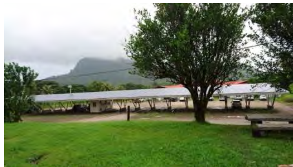
EU の援助で据付けられた太陽光発電システム
