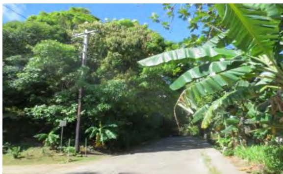
既設配電設備の様子(レラ地区)
