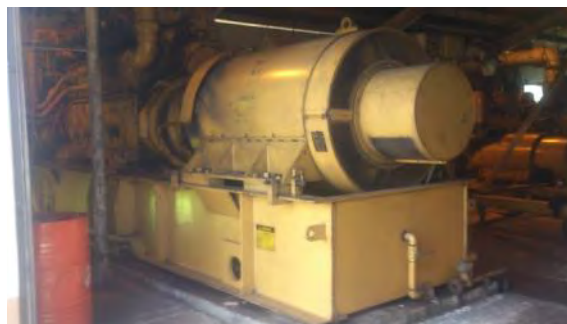
ディーゼル発電機 (6号機) の状況
