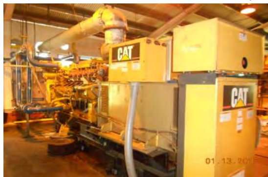
ディーゼル発電機 (8号機) の状況
