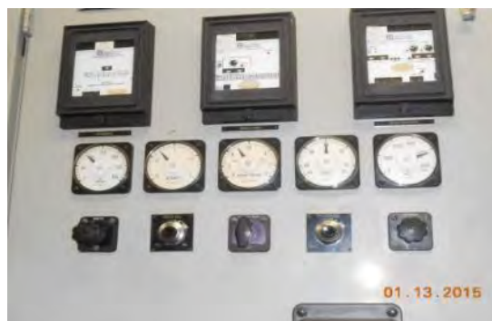
ディーゼル発電機制御盤
