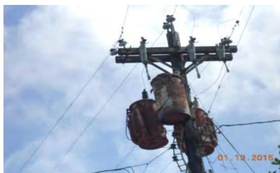
既設配電設備の様子 (レラ地区)
