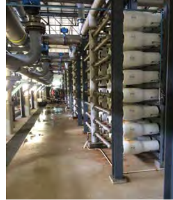
RO 膜処理装置
