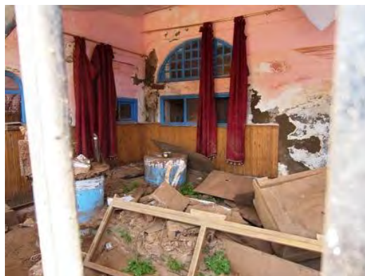
洪水被害で全損したサハラカクタス社旧工場 (2015年5月調査団撮影)
