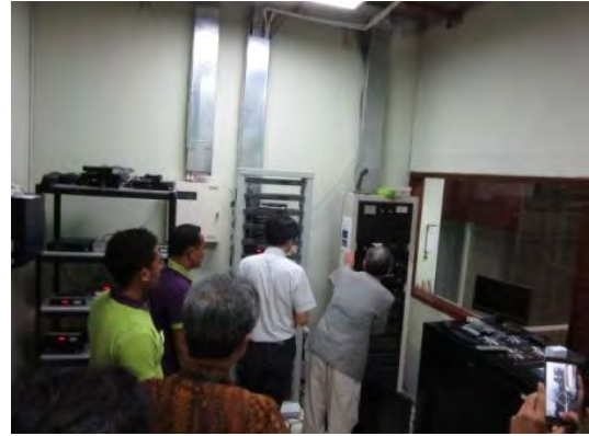
Ibis Style Hotel 設備室内
