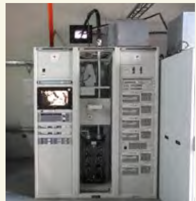
EWBS用デジタル送信機材【写真提供：八千代エンジニアリング株式会社】
