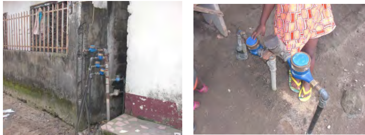
Figure 2-24 : Tuyaux de branchement d'eau
