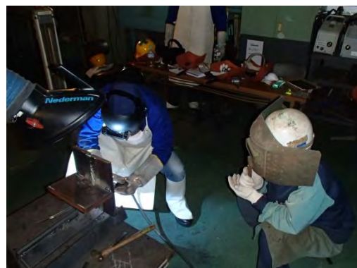
片面半自動溶接、立向上進溶接 ワイヤ：DW-100V 裏当て材：FBB-3
