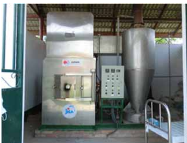
ルアンプラバン県立病院に設置された感染性医療廃棄物焼却炉
