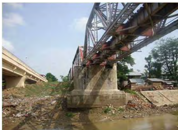
洗掘された橋脚
