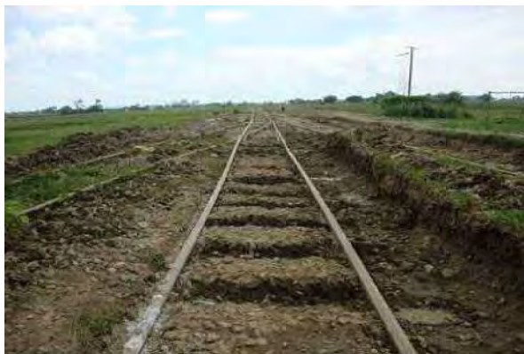
軟弱地盤に埋もれた軌道
