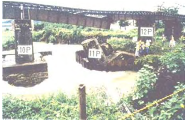
JR花輪線 橋脚洗掘・倒壊事例
