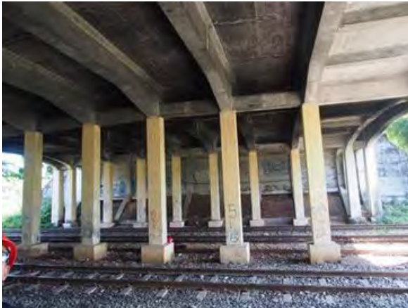
(3) 跨線道路橋 桁下面ひび割れ、柱損傷
