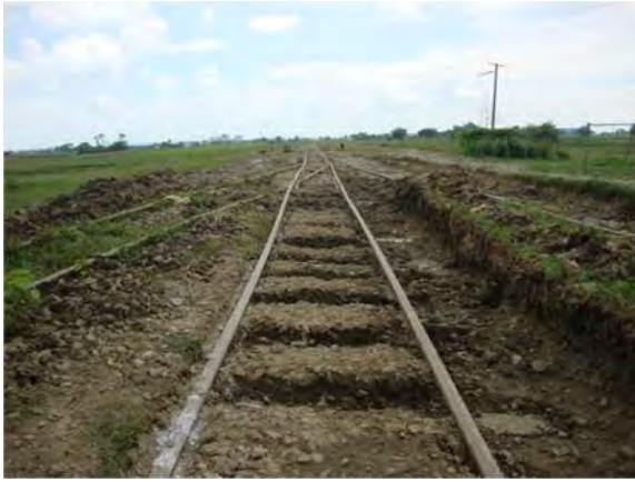
(1) 路盤の中に沈下した軌道（超軟弱地盤）
