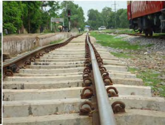
(2) 道床の不足・軌道変位
