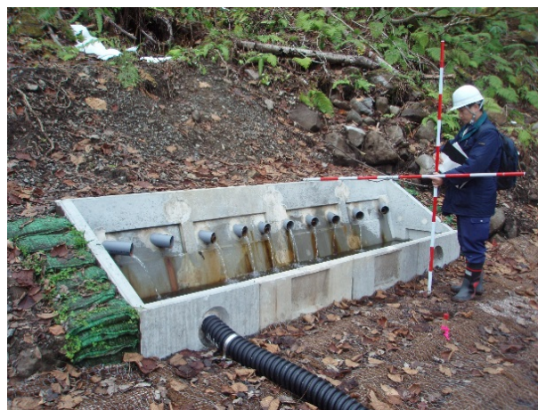
Muro de protección de la boca del orificio a base de concreto.
