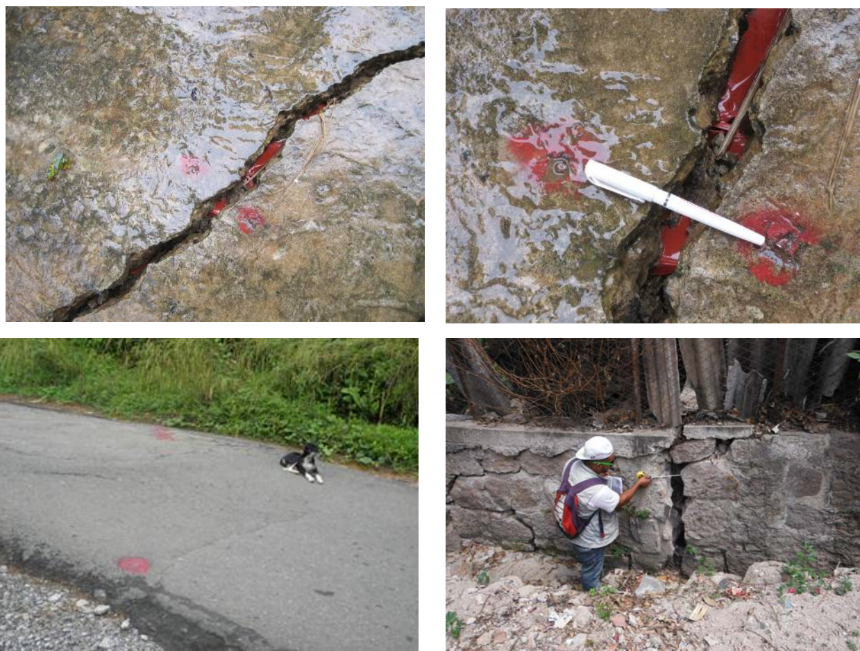
Figura 1.6.4 Medición de la grieta en la superficie de la calle y en un muro
