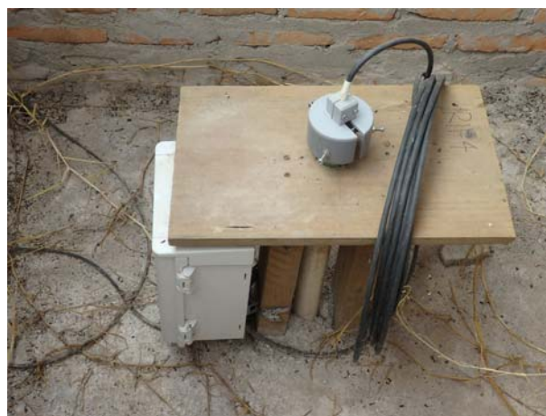
Registrador de datos y cable
