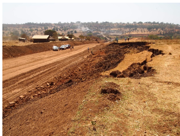
Desmoronamiento del borde de la parte superior del talud.
