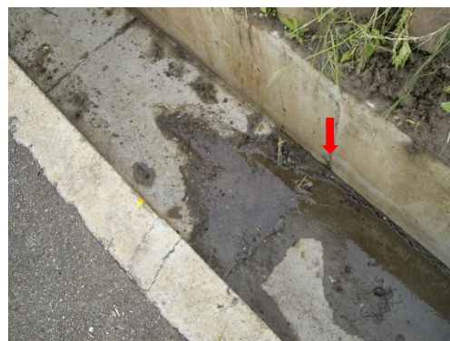
Figura 2.2.6 Brotes de agua en las uniones del canal (flecha roja) (Fuente: JCT)
