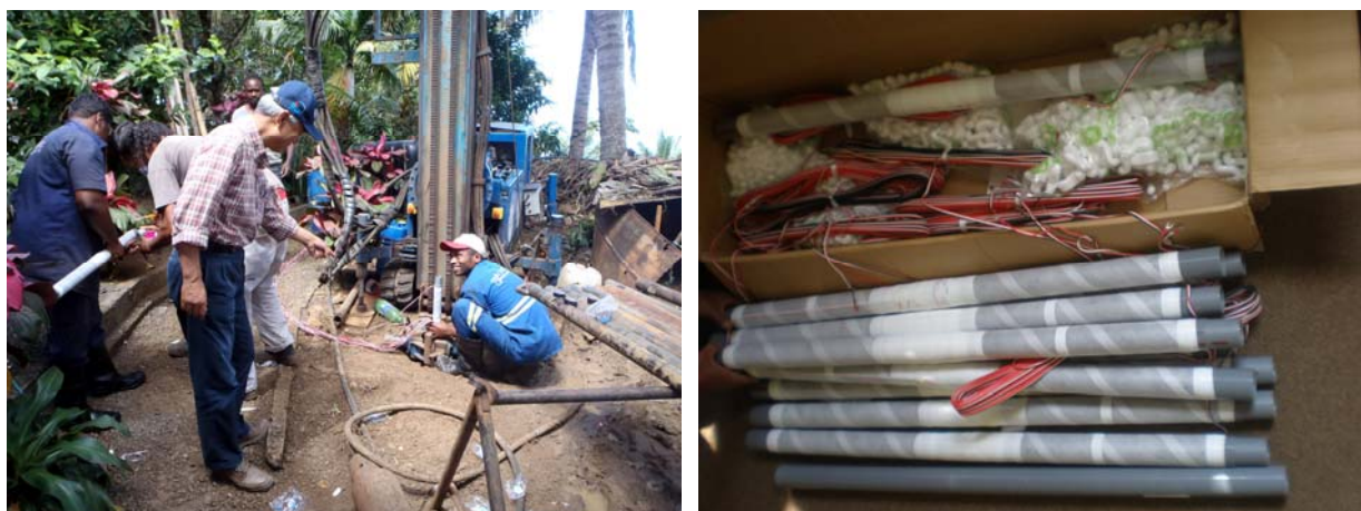
Figura 1.7.1 Instalación del inclinómetro tipo tensiógrafo (izquierda) e inclinómetro (derecha) (Fuente: JCT)
