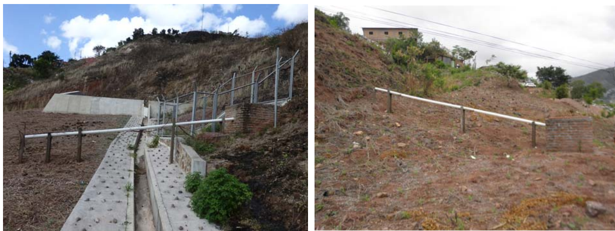
図1.3.1 Reparto 地区に設置されている地表面伸縮計 (出典：JCT)
