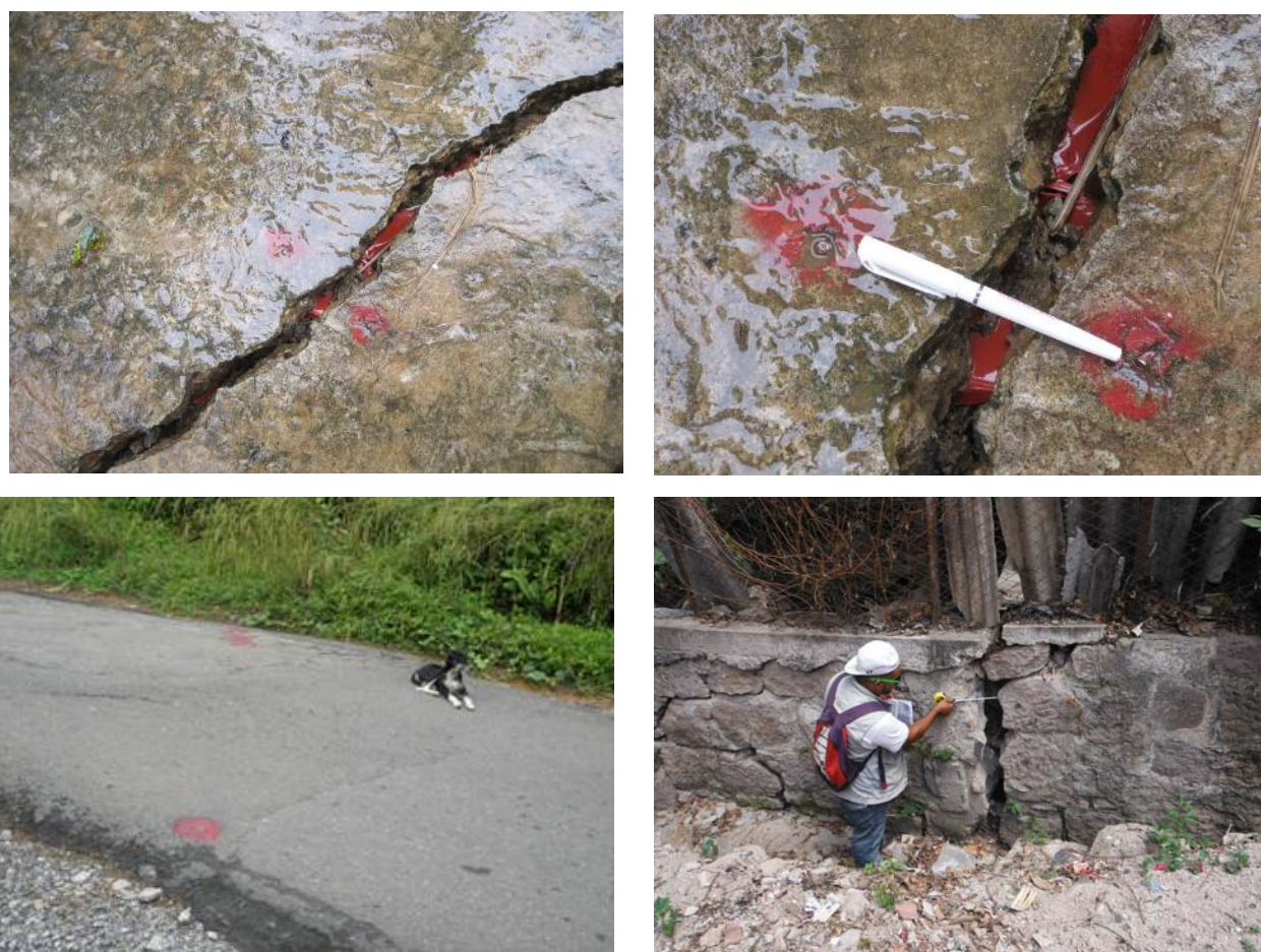
図1.6.4 道路面や塀でのクラック計測 (出典：JCT)
