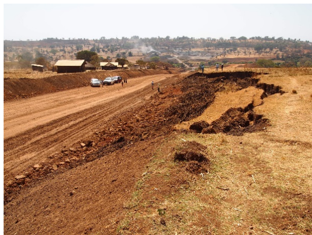
切土のり面肩部からの崩壊
