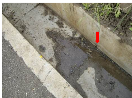
図2.2.6 水路の継ぎ目からの湧水（赤矢印） （出典：JCT）
