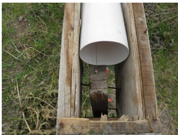
保護管が移動杭に当たっている (日変動の原因となる)
