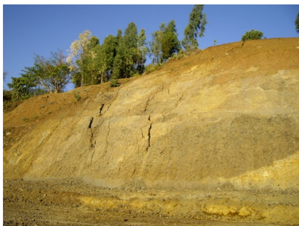
切土のり面にみられる亀裂
