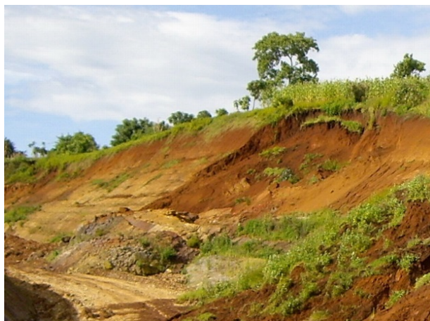
切土のり面の表層崩壊
