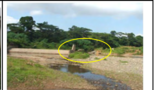
2012年3月洪水後被災状況写真(全景)
