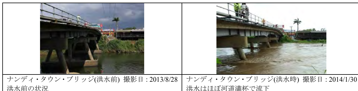
写真 2-1 洪水時の状況写真(2014年1月洪水)
