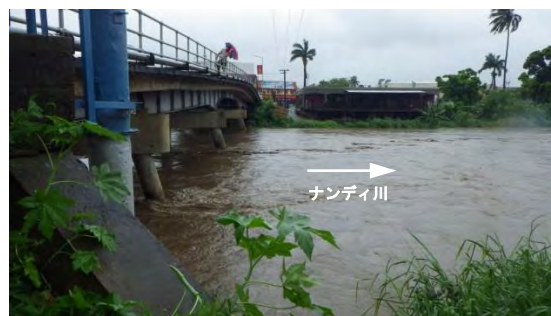
写真-10 ナンディ川 (Nadi Town Bridge) /洪水時
