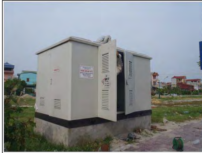
Hình 7-36 Trạm biến áp ngoài trời hiện hữu
