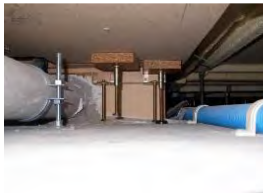
図2 床下の配管写真
