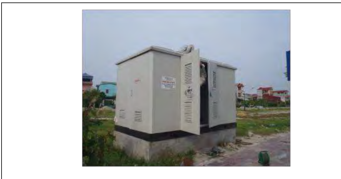
図 7-36 既設の変電所
