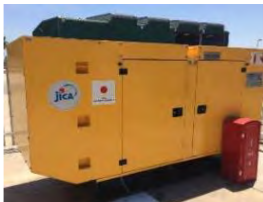
発電機は 250 時間毎に保守点検
