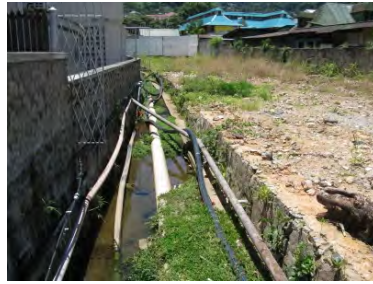
写真 5-2-2: 障害物 (River Maintry)
