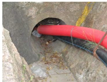
写真 5-2-5: 合流点の障害物 (5th June Avn. and Manglier Rd.)
