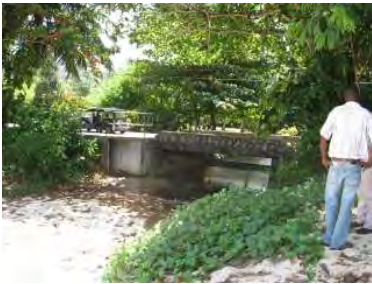
写真 5-2-19: 排水路 A の河口閉塞 (April 2011)
