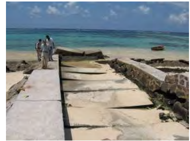
写真 5-2-21: 侵食による損傷を受けた河口部 (April 2011)
