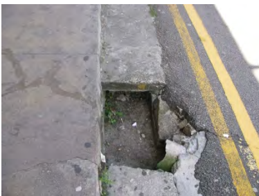
写真 5-2-4: 側溝の損傷 (Market Street)
