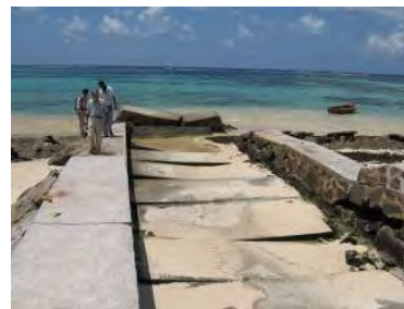
写真 5-2-111: 侵食による損傷を受けた河口部 (April 2011)
