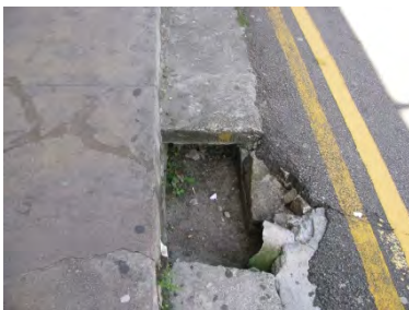
写真 5-2-4: 側溝の損傷 (Market Street)
