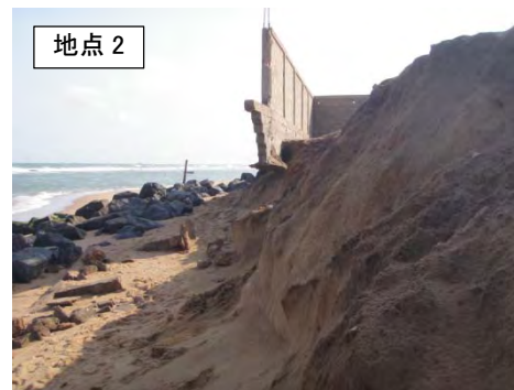
海岸侵食で崩れたブロック塀
