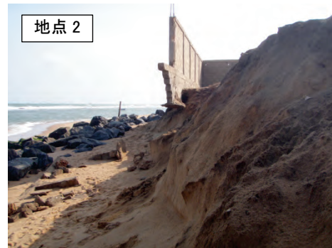
海岸侵食で崩れたブロック塀
