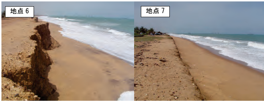
ロメ～アネホ中間付近の海岸侵食
