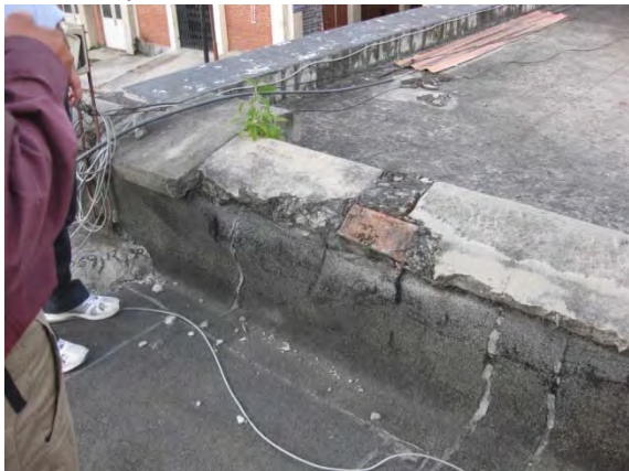
施設屋上の防水処理。風化によりアスファルトは亀裂、破損が著しい。本協力対象事業では一部施設の屋上防水工事を行う。
