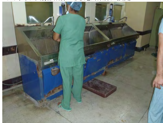
手洗い装置。1980年代に我が国の無償資金協力で整備。 30年以上使用しているため錆、腐食が著しい。
