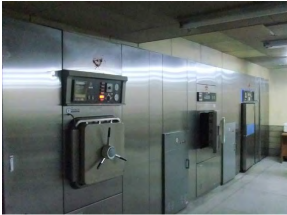
高圧蒸気滅菌器（日本製、機齢20年以上、配備数4台） 手前の1台のみが不調を繰り返しながらも稼働している。
