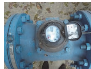
【写真 1-1】他国製既設の機械式取水流量計
