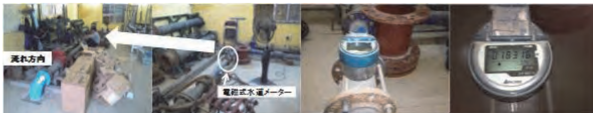
写真2-1 ハイフォン水道公社の検定設備における設置状況
