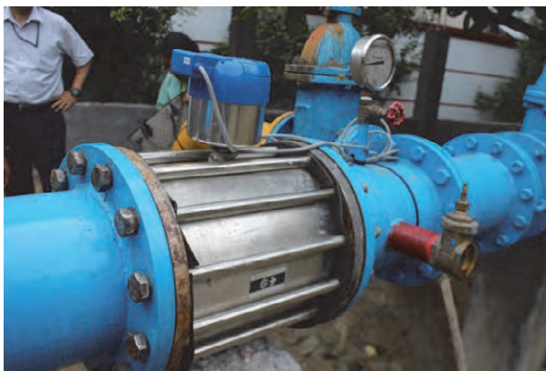
電磁式流量計の設置風景①
