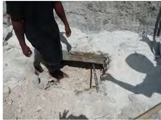
パラペット基礎下部の空洞
