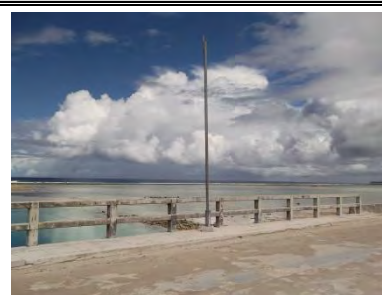
【写真-12】歩道に設置された照明柱(使用されておらず支柱基礎のみ残る)
