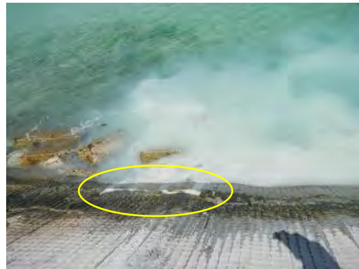
クラックからの裏込投入材の流出
