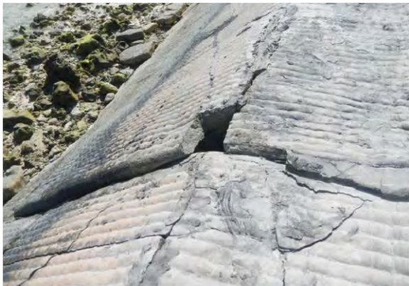
護岸法面マットの剥落
