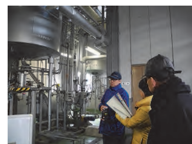
写真 2.29 本邦研修風景 (京都市廃食用油燃料化施設)
